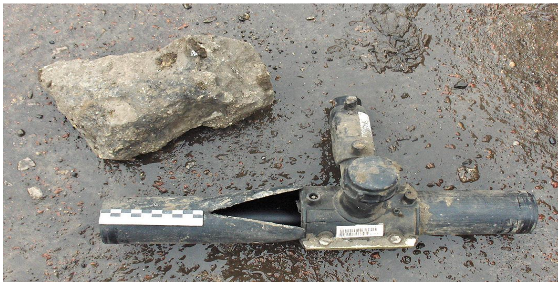
Фото 5. Общий вид порыва газовой трубы (после её демонтажа) и природного камня, который находился непосредственно на данной трубе
