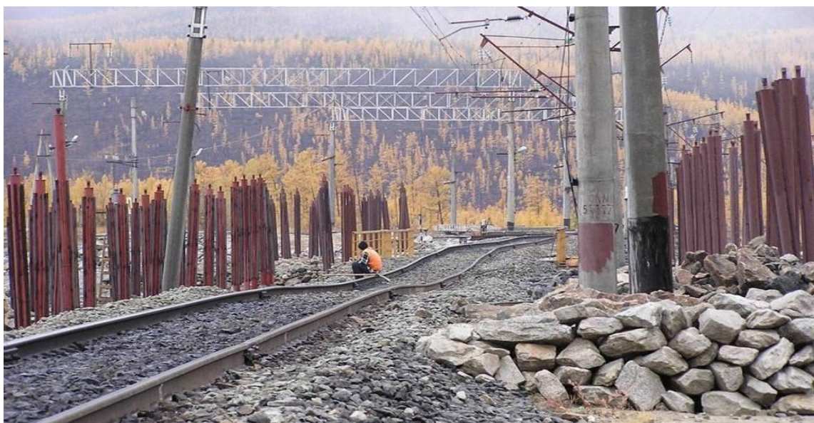
Рис. 4. Участок многолетних деформаций пути и опор контактной сети БАМ [7]
