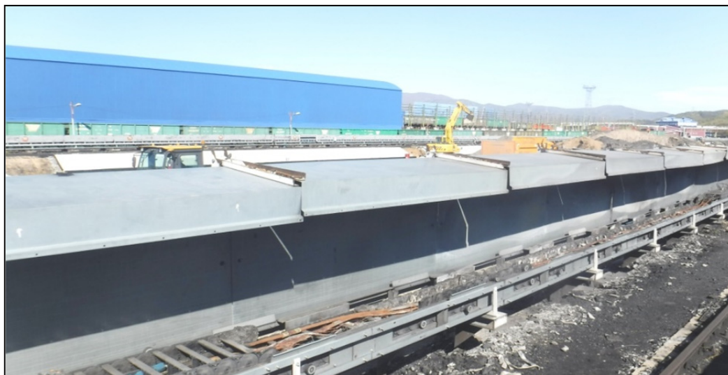
Рис. 4. Термические поражения участка кабельной цепи системы пылеподавления «Стакер»
