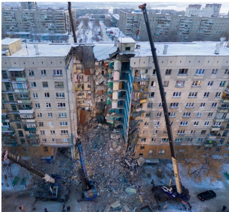
Рис. 2. Разрушенный многоквартирный дом в г. Магнитогорске, 31.12.2018 г.
