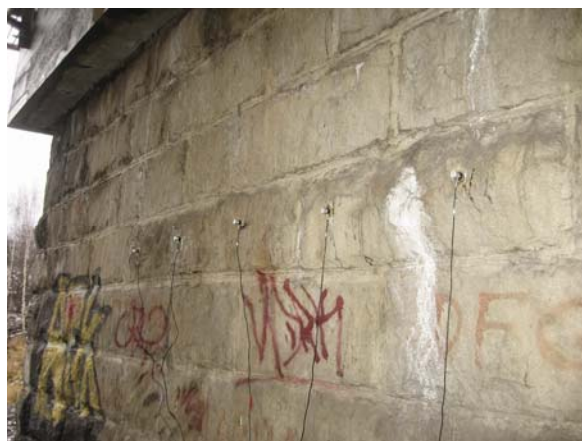
Рис. 2. Пример расстановки акселерометров при проведении исследования прочностных характеристик мостового сооружения
