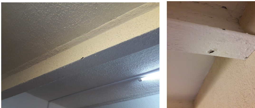
Рис. 6. Повреждения огнезащитного покрытия. Слева: скол покрытия в нижней части балки; справа – высверлено отверстие в нижней полке двутавра, срез не покрыт огнезащитным слоем
