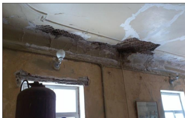
Рис. 2. Разрушение внутренних строительных элементов зданий
