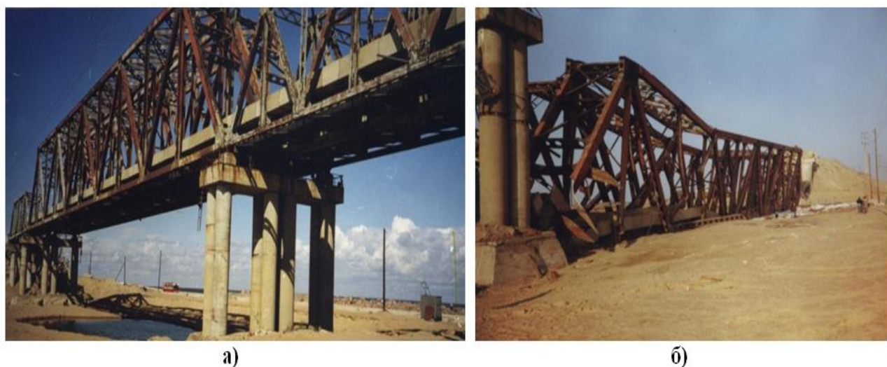
Рис. 2. Обрушение транспортного моста с применением ЗУВР: а) мост до разрушения; б) мост после разрушения
