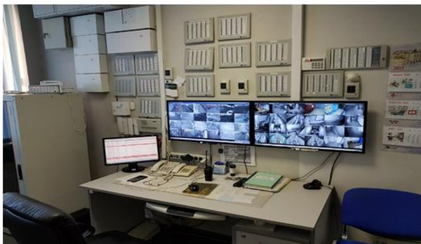
Рис. 5. Модуль управления мониторингом и контроля пожарной безопасности объекта объединенного учреждения ФСИН
