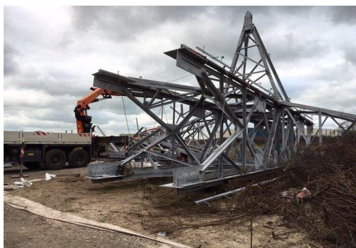
Рис. 5. Образование завала вследствие падения ВС на телевышку ( https://hosting.kitchen/ovh/gra-the-new-electricity-pylon-for-our-dc-225kv-40mva.html )
