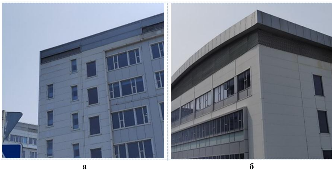
Рис. 2. а) Вентиляция корпуса F; б) Вентиляция корпуса E
