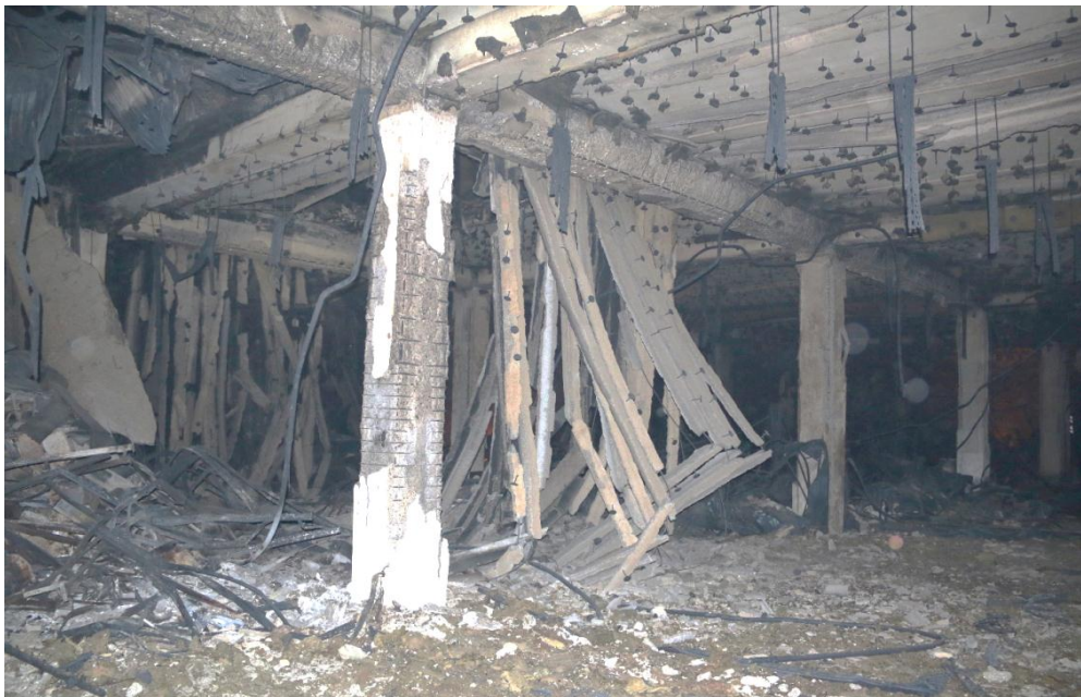
Рис. 1. Разрушение железобетонных несущих конструкций в результате пожара
