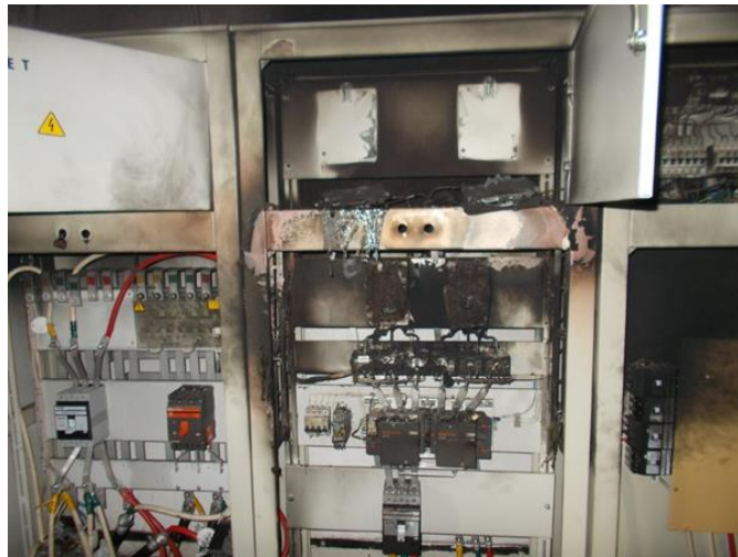
Рис. 3. Последствия короткого замыкания в электрощите
