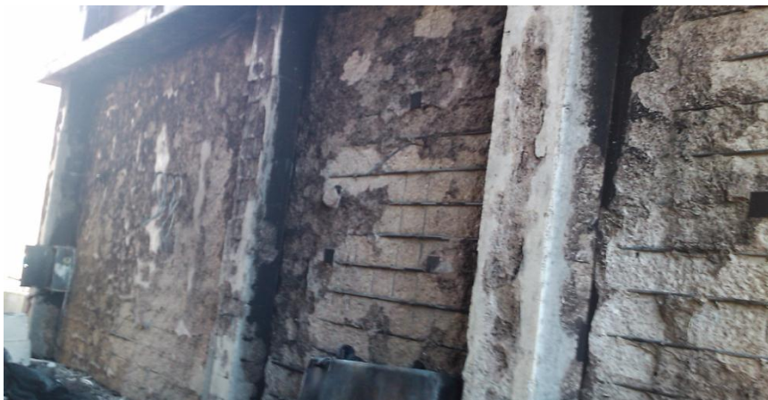
Рис. 4. Утрата защитного слоя бетона. Оголенная арматура
