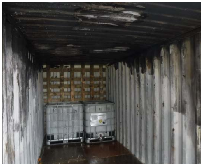
Рис. 4. Термические поражения внутри контейнера: лакокрасочное покрытие контейнера карбонизировалось преимущественно в верхней его части
