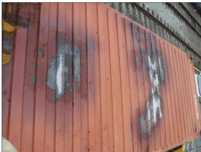
Рис. 3. Термические поражения верхней стенки контейнера
