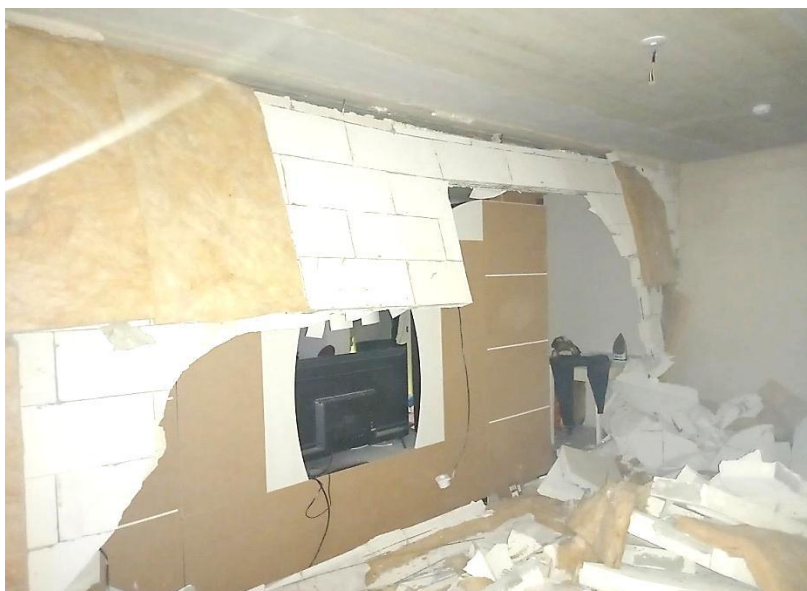
Рис. 4. Разрушения межквартирной стены в комнате квартиры вследствие взрыва, произошедшего в помещении кухни
