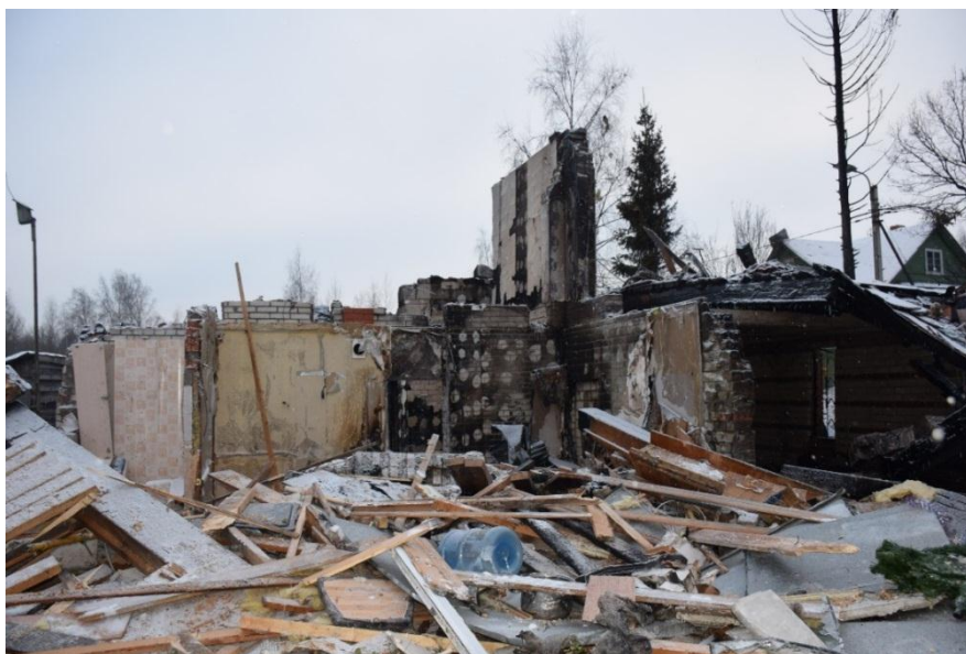
Рис. 6. Вид дома после взрыва бытового газа
