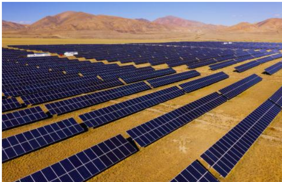
Рис. 6. Одна из двух солнечных электростанций в Кош-Агачском районе Республики Алтай 15
