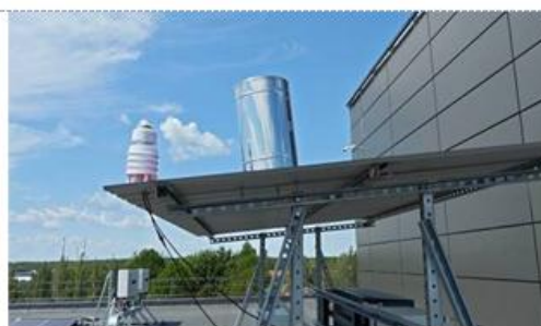
Рис. 2. Метеостанция RS485, модель 486 в г. Рязани в районе Восточный Промышленный узел, июнь 2025 г.
