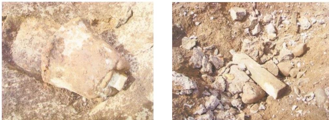
Рис. 5. Разрушение бетонного блока
