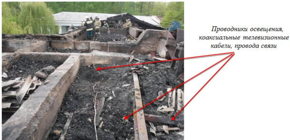
Рис. 2. Общий вид участка крыши над центральным крылом здания в южной его части над рентген-кабинетом и центральной лестницей. Место расположения очага пожара в центральной части снимка. Стрелками указаны провода связи, коаксиальный телевизионный кабель и остатки старых проводников освещения
